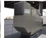
非常用発電機
