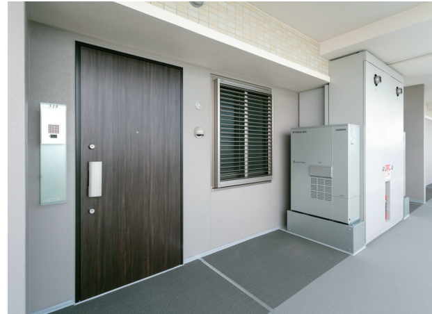
玄関横 エネファーム置場
