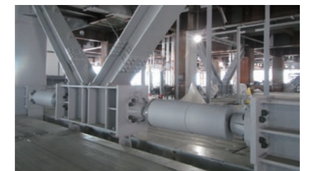
制震部材（オイルダンパー）
