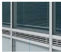
自然換気装置（外部）
