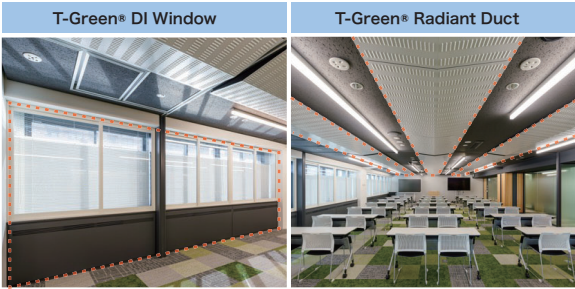
8階人材研修センター教場に採用した高断熱窓システム・薄型放射空調ダクト
