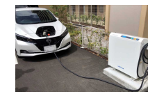
非常用に使えるEV充電設備
