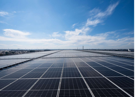
太陽光発電設備
