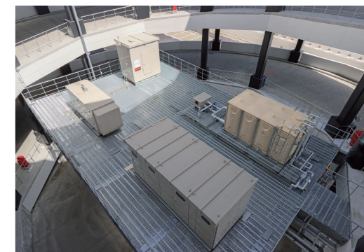
ランプ設備架台
