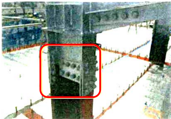
高力ボルト接合部の不具合事例
