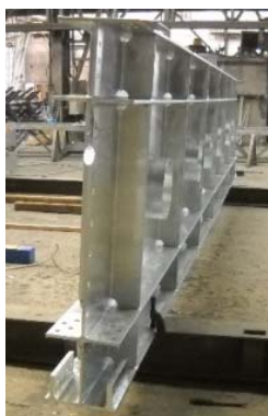
断面が細長い梁で曲がりが生じた例
