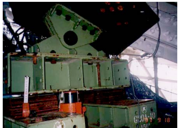
屋根鉄骨の仮設支持部 (オレンジ色は油圧ジャッキ)
