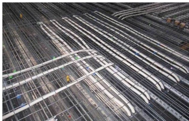
合成スラブデッキ電気配管不具合事例 (50 と配管が太く、鉄筋、デッキと接している)
