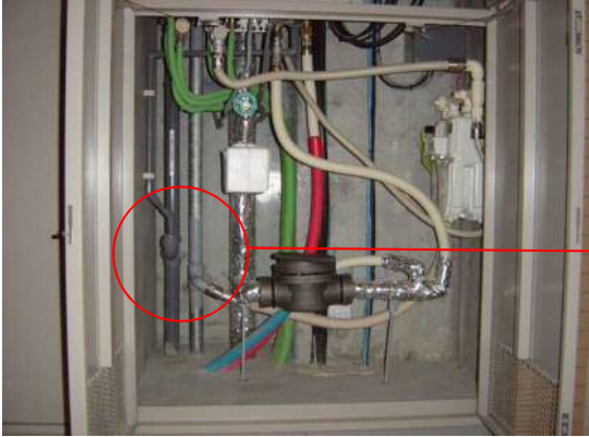
給湯器下部配管状況
