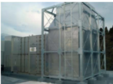
大規模タイプ対応例 (某給食センター厨房用)
