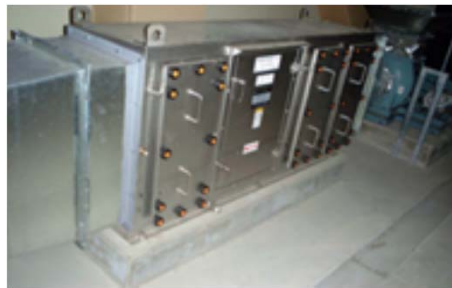
中規模タイプ対応例 (某ショッピングセンター内厨房) Q=7,000m 3 /hr
