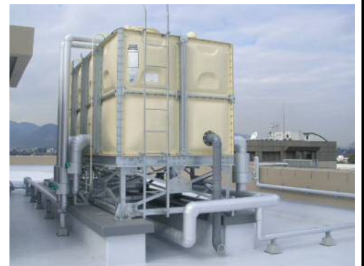
写真-7 高置水槽（FRP製）の配管支持例
