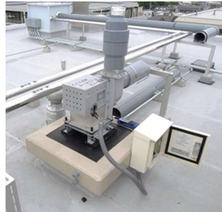
図 1 屋上の臭突ファン
