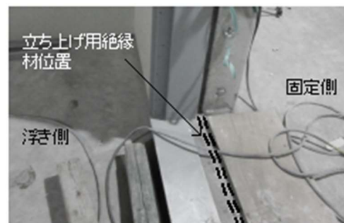
写真2 扉位置での施工不良例
