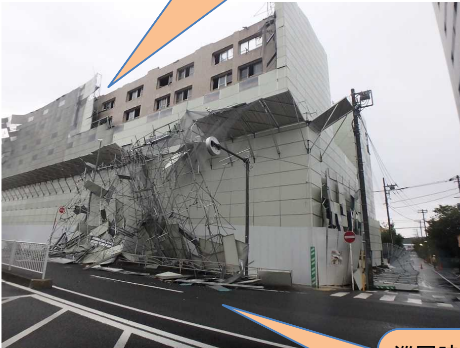
東側足場倒壊状況
