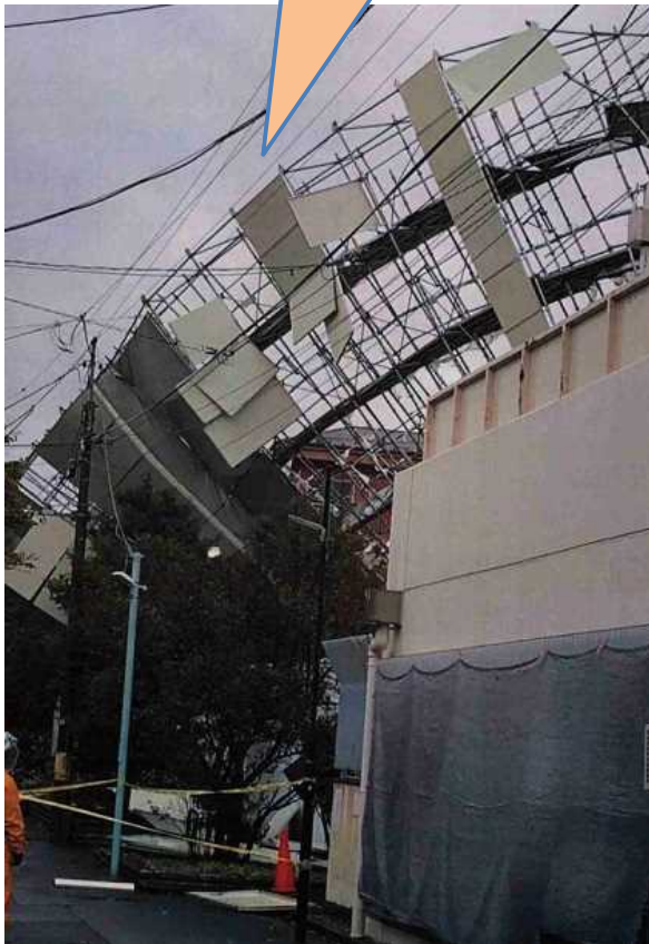
西側足場倒壊状況
