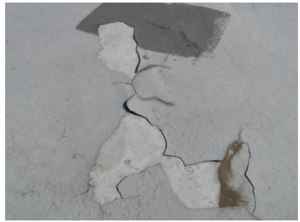
写真 2.1.2 防水層の破損の事例
