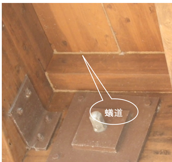
写真 2.2.5 しろありの蟻道の事例
