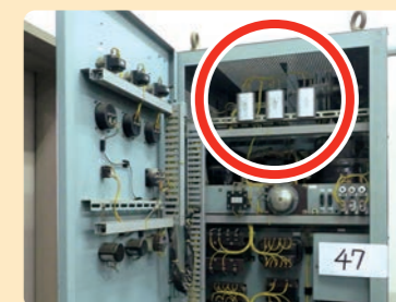
可変周波数電源装置に取り付けられた低圧コンデンサー
