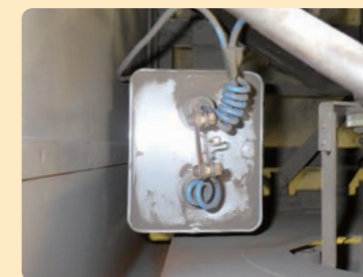
電気溶接機の内部に取り付けられた低圧コンデンサー
