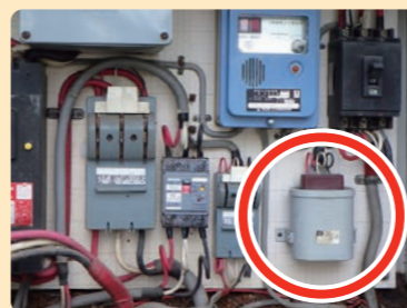
低圧分電盤内の低圧コンデンサー
