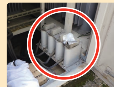
キュービクル内に残置された廃コンデンサー
