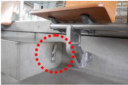
・観覧席の下部に設けられた補聴器用アンテナ線の差し込み口
