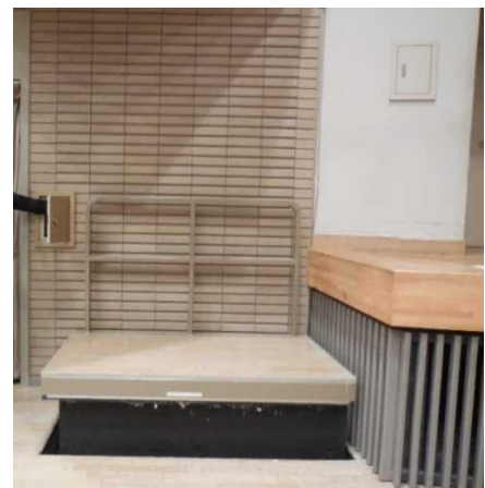
・舞台の袖に設けられた段差 解消機
