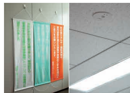
右／オフィスフロアに昼光センサーを導入。外光の明るさを利用し、室内照明の照度を自動調光する。 左／一般利用者に省エネへの理解と協力をPR。
