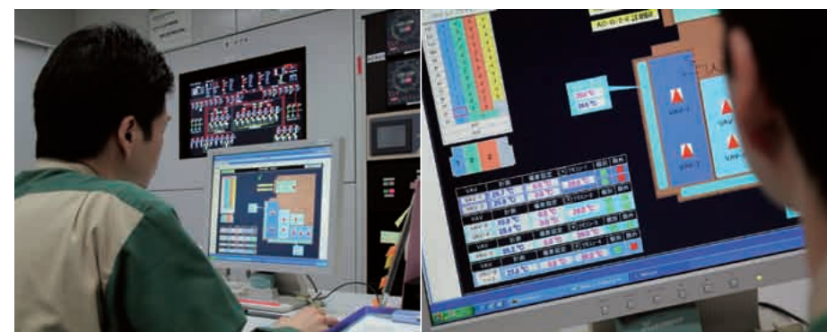
左／防災センターに設備スタッフが常駐し、ビル全体の室温管理などが行われている。 右／オフィス各フロアの空調ゾーンごとに、リアルタイムで温度を計測し、パソコン上で設定温度管理などができる。夏季の設定は28℃。
