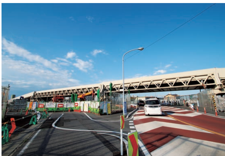
一般道と交差する工事車両専用のオーバーブリッジ。周辺 の交通環境に及ぼす渋滞などの影響を回避している。
