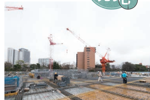
屋上では配筋とコンクリート打設が進行中。写真右手は代官山、左手は恵比寿の方向。周辺は都心では貴重な森に包まれている。
