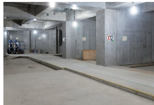
2階ホールの楽屋とレッスンス室。床に段差があるのは、遮音、防振のためにグラスウールなどを充填してから仕上げるため。
