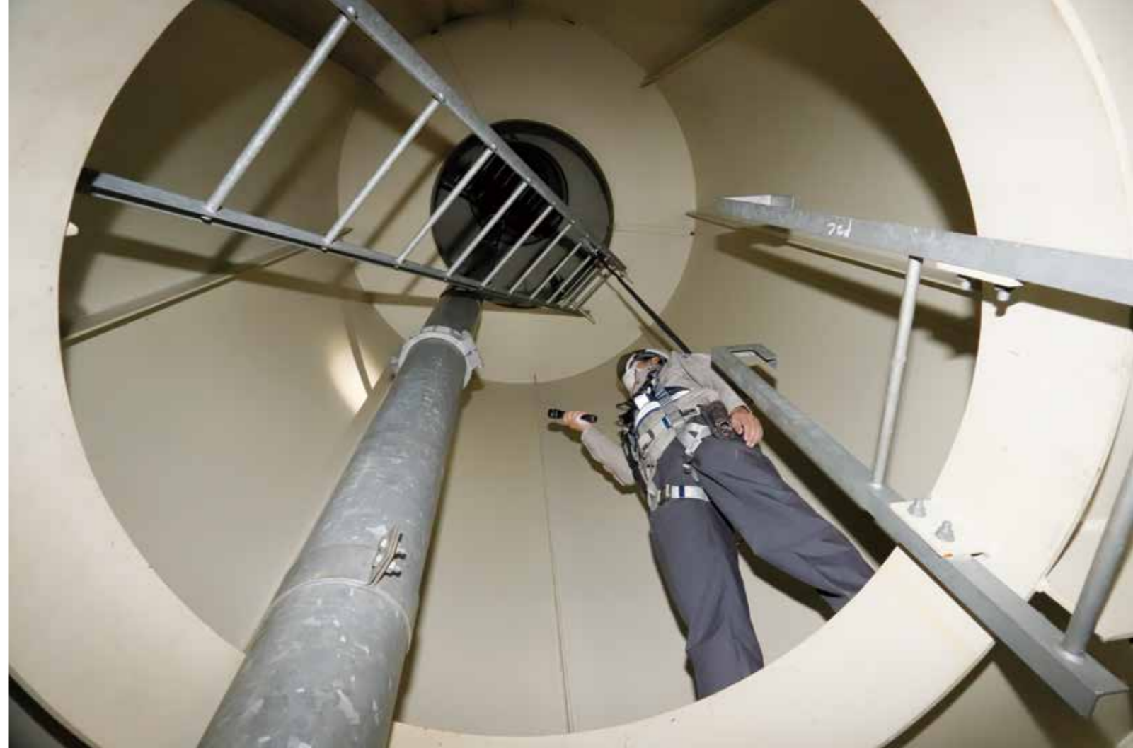
円形の鋼製橋脚内部。内側から補強する際は、メンテナンス用の開口部から出入りする
