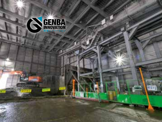
多機能防音ハウスの内部。ここには掘削した土砂や資機材などが仮置きされている。
