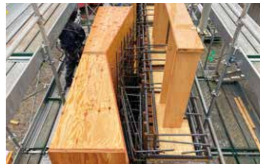
ファサードのモックアップ。右側が鉄骨を模して組んだ木の模型で、鉄筋や型枠は実際と同じサイズ・材質で試験施工した。（画像提供：岩田地崎建設株）
