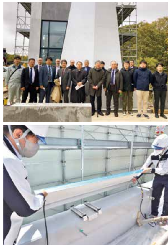
上／ファサードのモックアップ試験に立ち会った伊東豊雄氏と池内和正社長（写真中央、伊東氏の右隣が池内社長）。方法と出来形を事前確認したことで、不安なく施工に臨むことができた。（画像提供：岩田地崎建設株） 下／融雪笠木用のヒーターを設置する。
