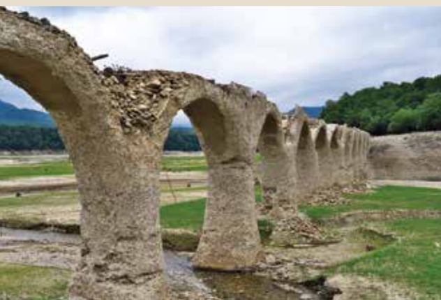
上流側は特に崩壊が著しい。表皮のコンクリートが裂けて中込の石材が崩落している。その時が近づいている予感がある。
