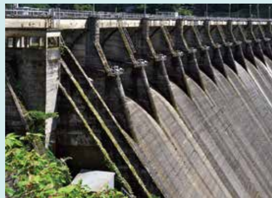
堤体の右岸側にエレベーター式魚道が設置された。下流側から遡上するアユなどの川魚を籠に誘導し巻き上げる仕組みだったという。設備は撤去されたが構造はそのまま残されている。
