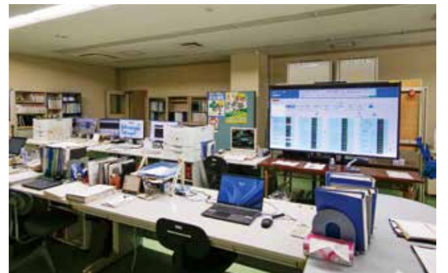
水質や設備の稼働状況を常時モニタリングしている
