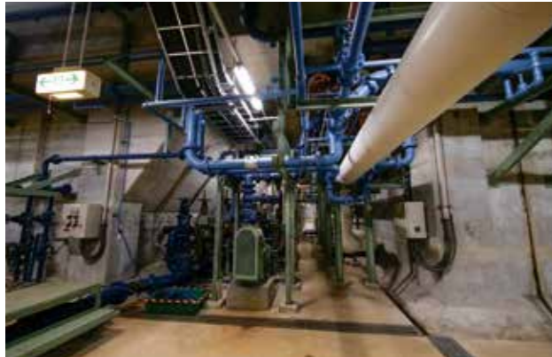
東部浄化センター内部の処理設備。複雑な工程を経て汚水を浄化し、東京湾に放流する。各プロセスで厳密な水質の測定が行われる。必要な箇所から更新を実施し、更にデジタル情報基盤を構築し、AIを活用したモニタリングや運用の高度化を目指す
