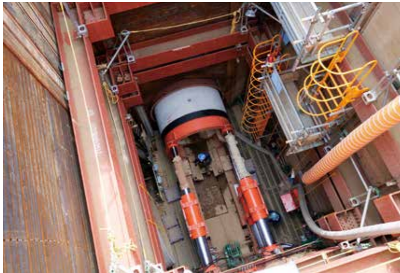
新設されるろ過池を避けて地中にトンネルを施工し、その中に改めて直径2mの幹線を敷設する。掘削は人力による刃口推進工法で慎重に進める
