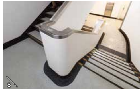
8) 曲線をもった金属の手すりは、意匠性もさることながら、手にやさしくフィットし機能性も高い。9) エレベーターホール脇の石張りの階段
