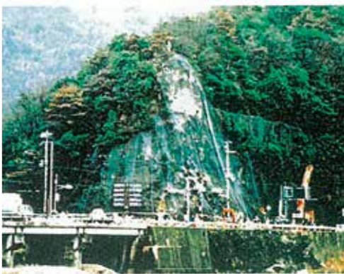
(写真3 国道176号生瀬地区の斜面崩落現場)
