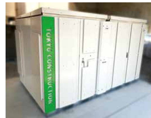
高架下に設置されたデータセンター
