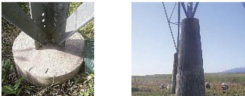
図-1.4.5 凍結融解による鉄塔基礎の劣化事例
