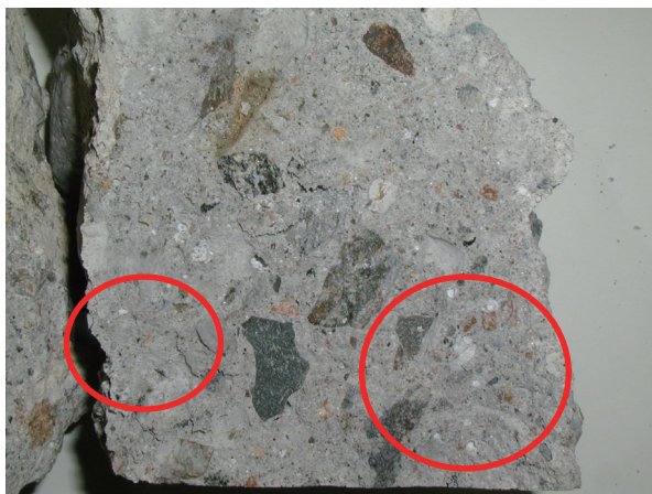
図-2.3.31 コア割裂面の状況
