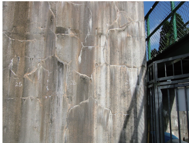
図-2.3.30 減勢工建屋に現れた変状
