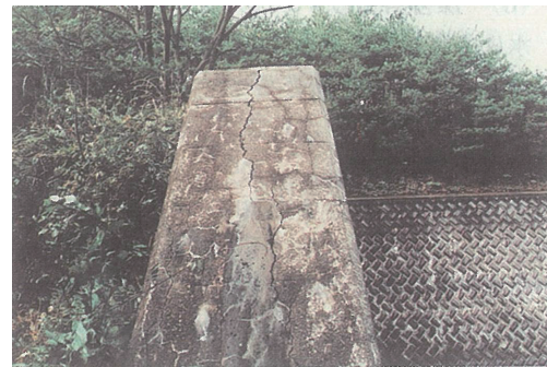
図-2.3.28 ASRによるひび割れの例 1) (拘束が大きい)
