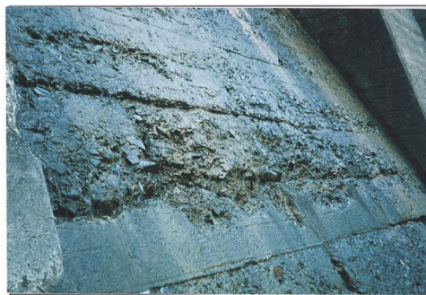
写真 補修前のダム表層部
