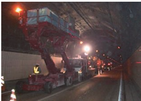
道路トンネルへの適用事例； トンネル覆工コンクリートの背面
