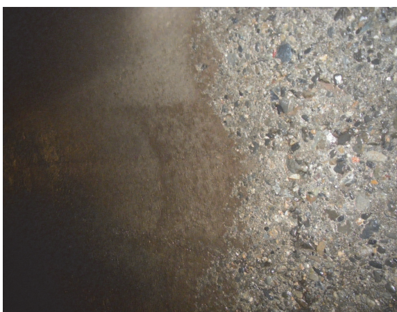
写真-3 洗浄による骨材の露出状況
