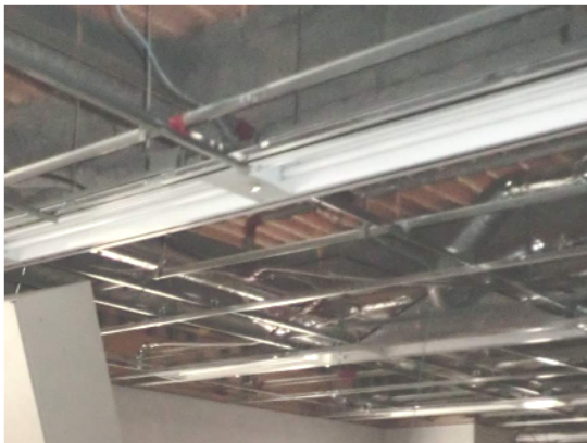
写真1 天井の罹災状況
