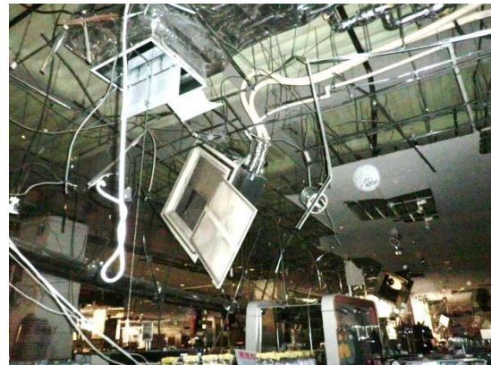
写真2 天井・設備の罹災状況
