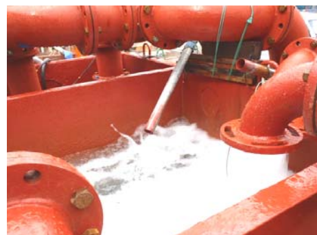
写真4 ノッチタンク稼働状況
