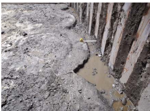
写真-7 SMW芯材と密着していない改良体
