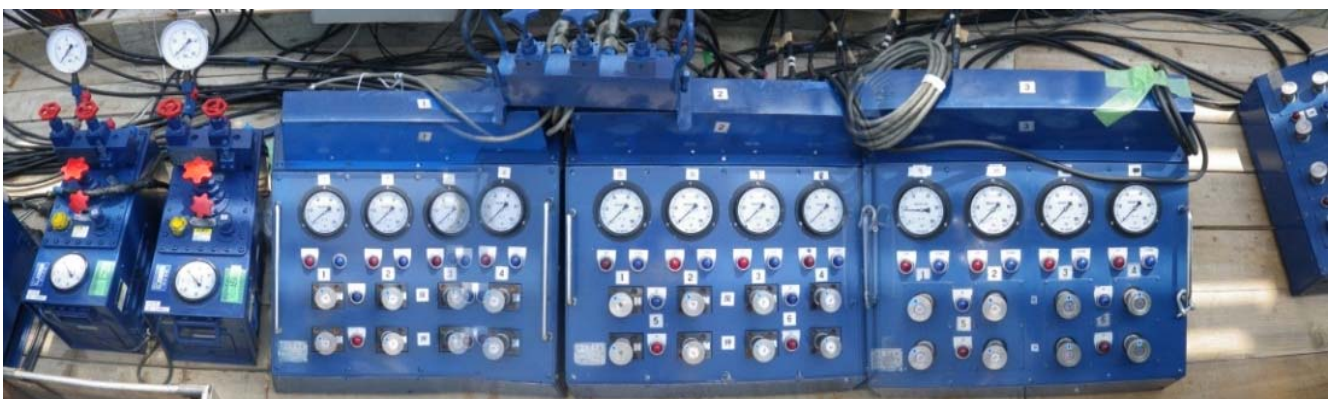
写真-10 垂直ジャッキ制御盤
