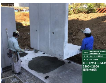
据え付け状況
