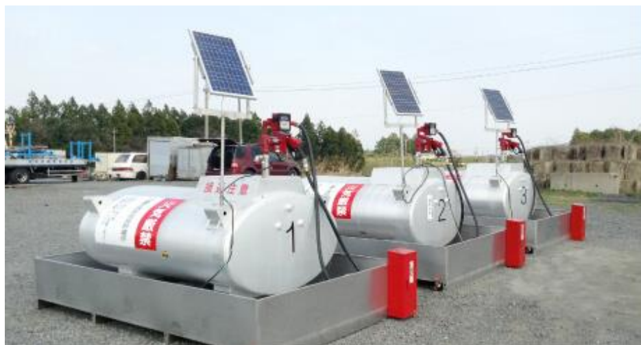
写真－１．一体型のタンク（商品名：スマートタンク）の事例
