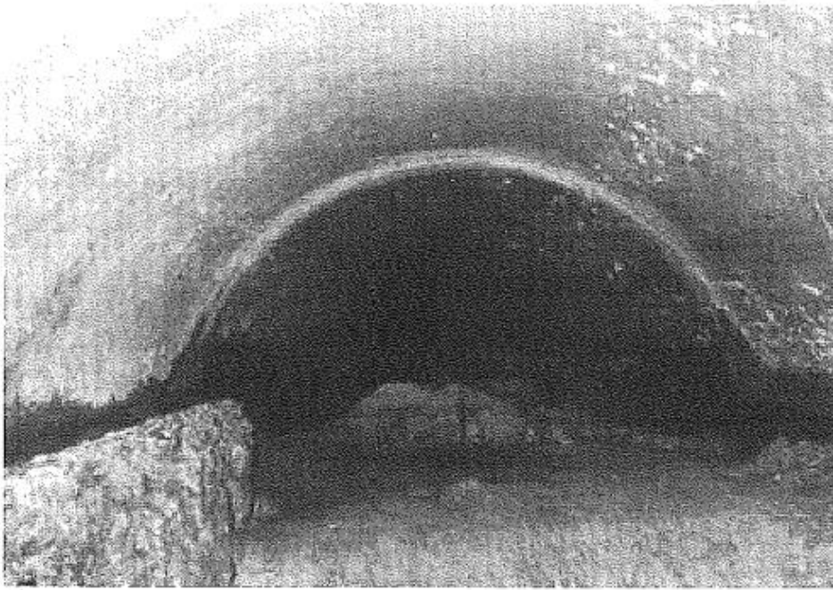
下水道管渠内のモルタル堆積状況
