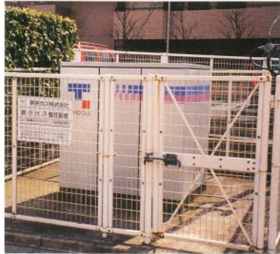
■ 地上整圧器室
