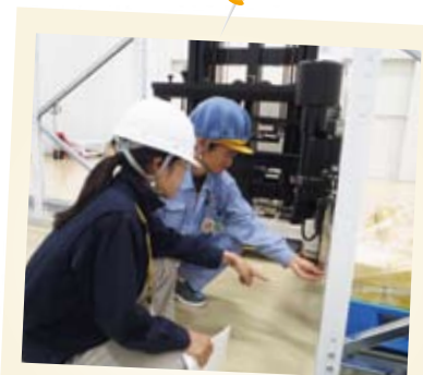
試運転調整では細かな制御の一つ一つが重要です
