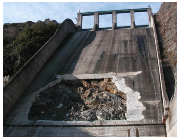
洪水吐破損状況
