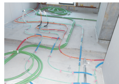
配管ユニット
