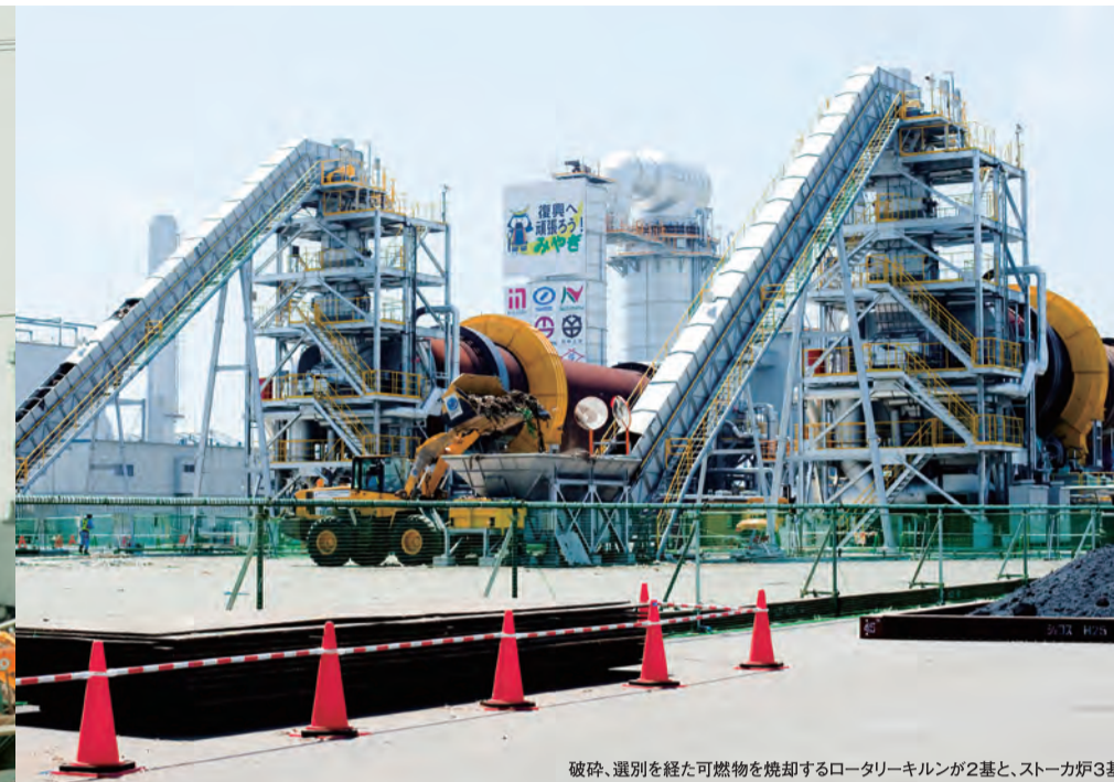
破碎、選別を経た可燃物を焼却するロータリーキルンが2基と、ストーカ炉3基。
