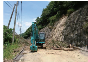
西日本豪雨災害 法面崩落対応
