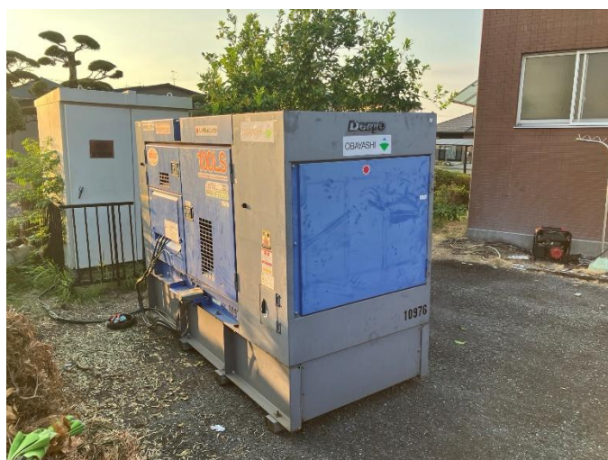
（設置完了した発電機）
