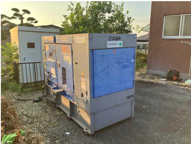
（設置完了した発電機）
