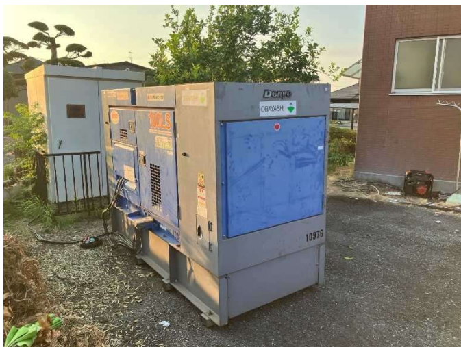
（設置完了した発電機）
