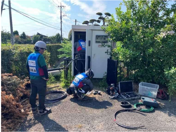
（八代市内の老人ホームへの発電機設置準備）
