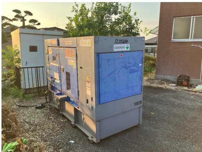
（設置完了した発電機）
